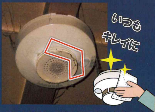
ほこりの溜まった住宅用火災警報器
