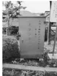
第1地区スタンドパイプ収納箱
